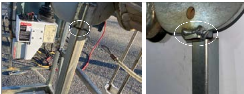
Figure 8 — Exemples de fissuration dans la traverse verticale
