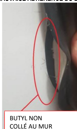
FIGURE 10 MAUVAISE ADHÉRENCE DU BUTYLE AU MUR
