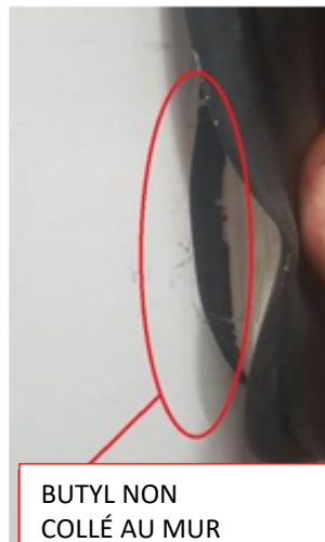
FIGURE 10 MAUVAISE ADHÉRENCE DU BUTYLE AU MUR
