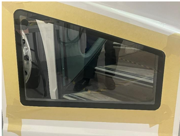
Figure 1 : Périmètre extérieur de la vitre inférieure de porte d'entrée
