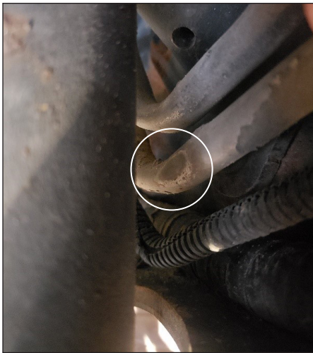
Figure 6 — Exemple de dommage de niveau remplacement de la canalisation de carburant – REMPLACEMENT REQUIS
