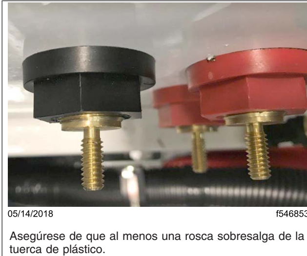
Fig. 4, Pasador instalado correctamente
