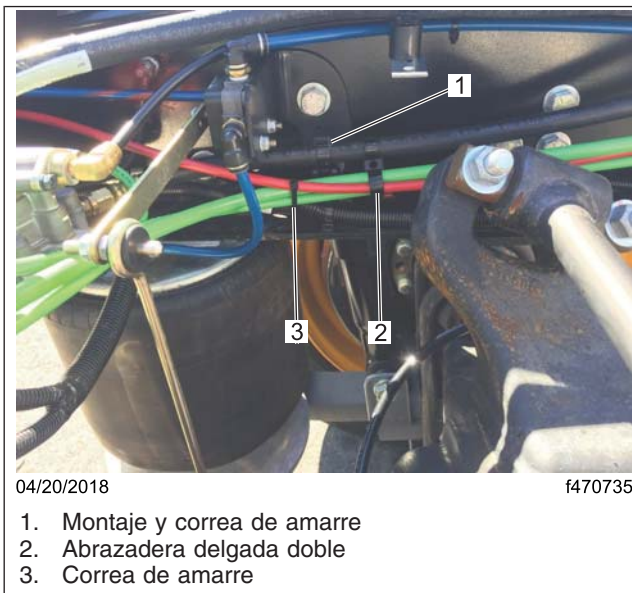
Fig. 14, Encaminamiento de las líneas de aire, válvula de control de altura simple
