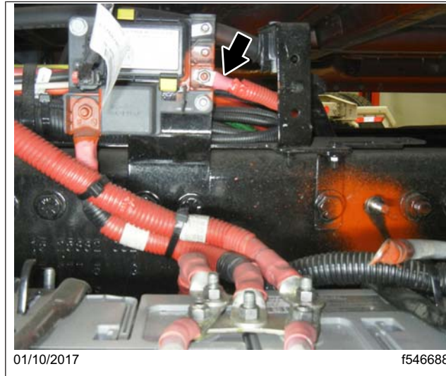
Fig. 28, Câble d'alimentation du module CPDM sur le boîtier PNDB
