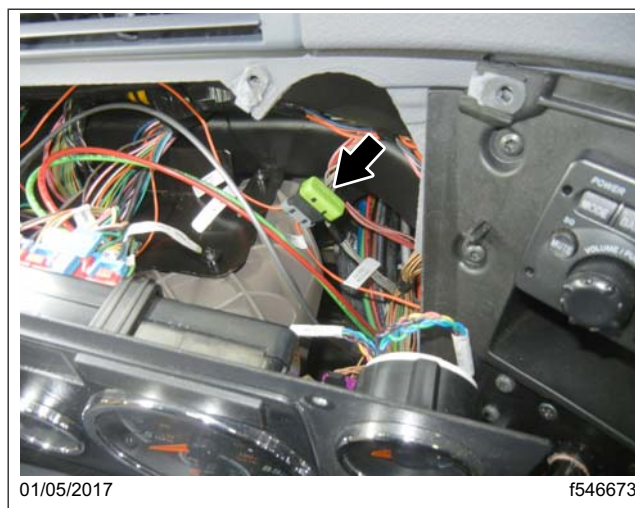
Fig. 13, Encaminamiento de la caja de empalmes
