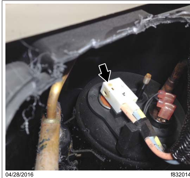
Fig. 8, Decoloración amarillenta y derretimiento del bloque conector
