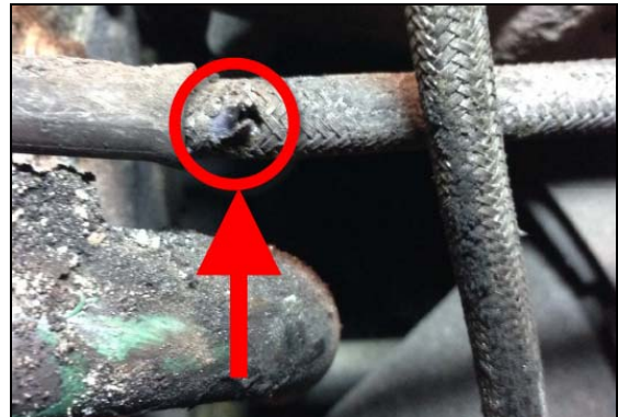
FIGURE 15: PERFORATION SUR LA CONDUITE DE CARBURANT
