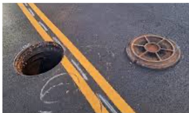
(d) Unsecured open manhole
