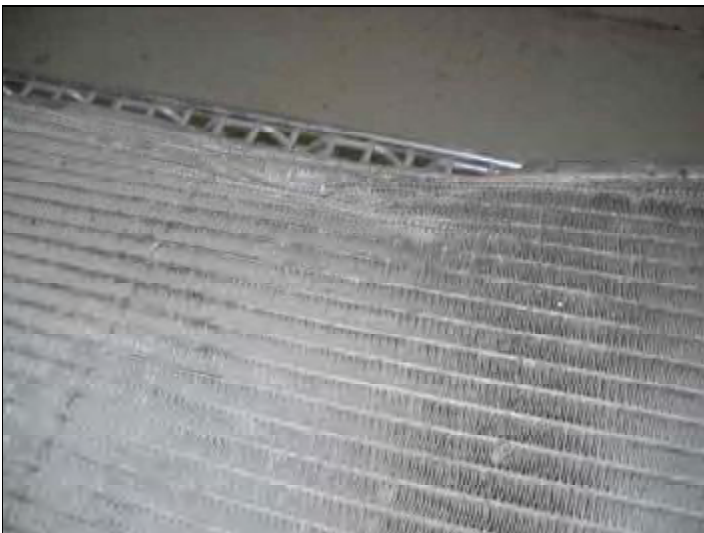
07/22/2010: EST01: ac condensor
